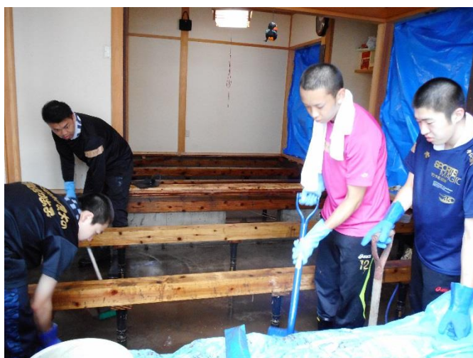
床板をはがした後の家屋で、床下の泥出しや洗浄を行いました。
